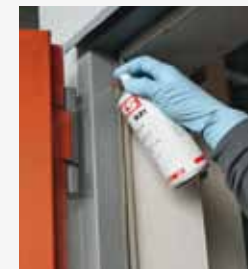
Scharnier-Schmierung von Feuerschutztüren
